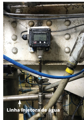
Excelsa instalado em uma linha injetora de água de uma centrífuga
