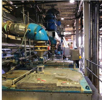
Línea de centrifugas en instalación de procesamiento de azúcar
