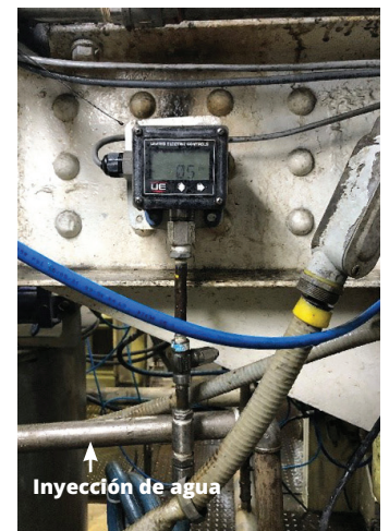
EXCELA instalado en una línea de inyección de agua en cada Centrifuga
